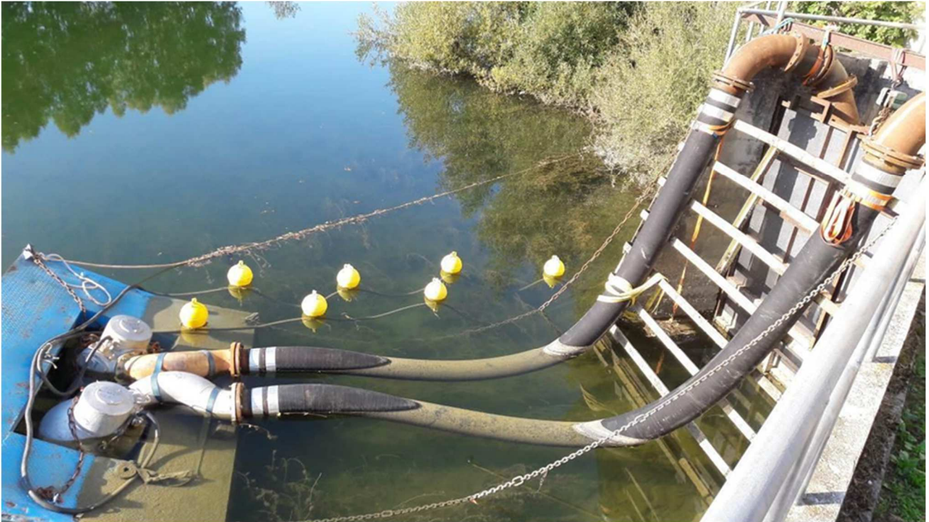
Pompe de secours dans le Doubs en septembre 2018 - Captage Mathay
